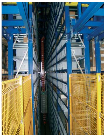
Per l'automazione del magazzino Neologistica, Jungheinrich ha installato 7 trasloelevatori LTW, dotati di inverter con il recupero di energia in frenata
